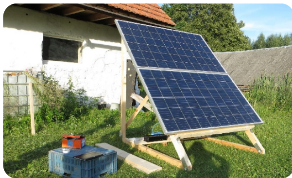
Kuva. 11. Valmis off-grid aurinkosähköjärjestelmä
